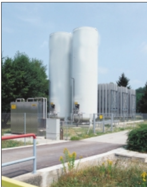
Obr. 6 Skladování kapalného kyslíku
